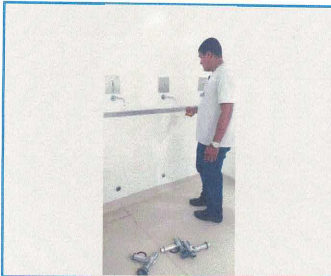
Obra: HOSPITAL DA MULHER DO RECIFE Legenda: Retirada de pia sem funcionamento no setor da CPN. Data da foto retirada: 14/02/2020
